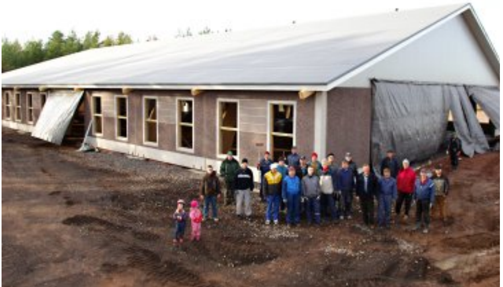
Oripään Lions Clubin kanssa rakennettavan hallin lattiaan raudoitustalkoihin osallistui runsaasti kerholaisia. (kuva Henry Viitanen 29.10.2011)
